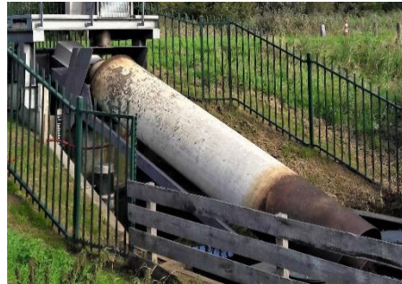
Foto 9 Visvriendelijk vijzelgemaal Koopmanspolder
